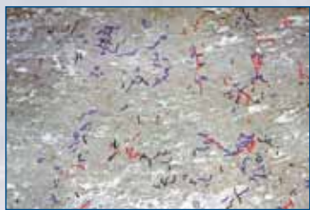
Razpoke v betonu brez dodatka FIBRILs
